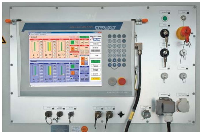
Anlagensteuerung und Fernbedienung
