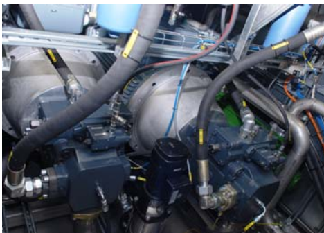
Pumpen im Aggregat
